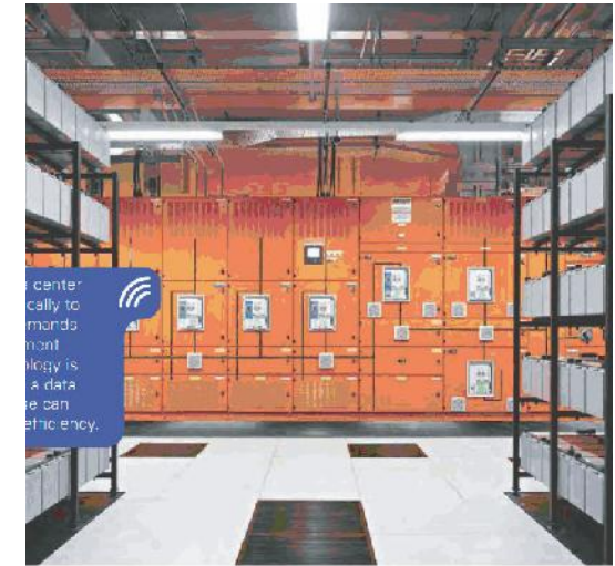
Terasaki ACBs schützen den Rechenzentrum des Telehouse Docklands
